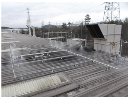
工場の屋根に設置した散水設備(長田野事業所)
